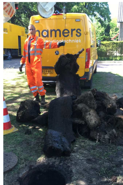
Figuur 10 Wortelingroei in de riolering toont de noodzaak van gedegen beheer en onderhoud aan
