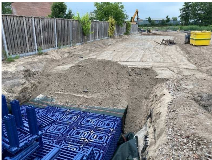
Figuur 27 Aanleg infiltratievoorziening bij supermarkt in Lochem; het afstromende hemelwater wordt in de kratten opgevangen om te infiltreren. Bij grote aanvoer (hevige regenval) wordt het overtollige water afgevoerd naar de gracht die afvoert richting de Berkel.
