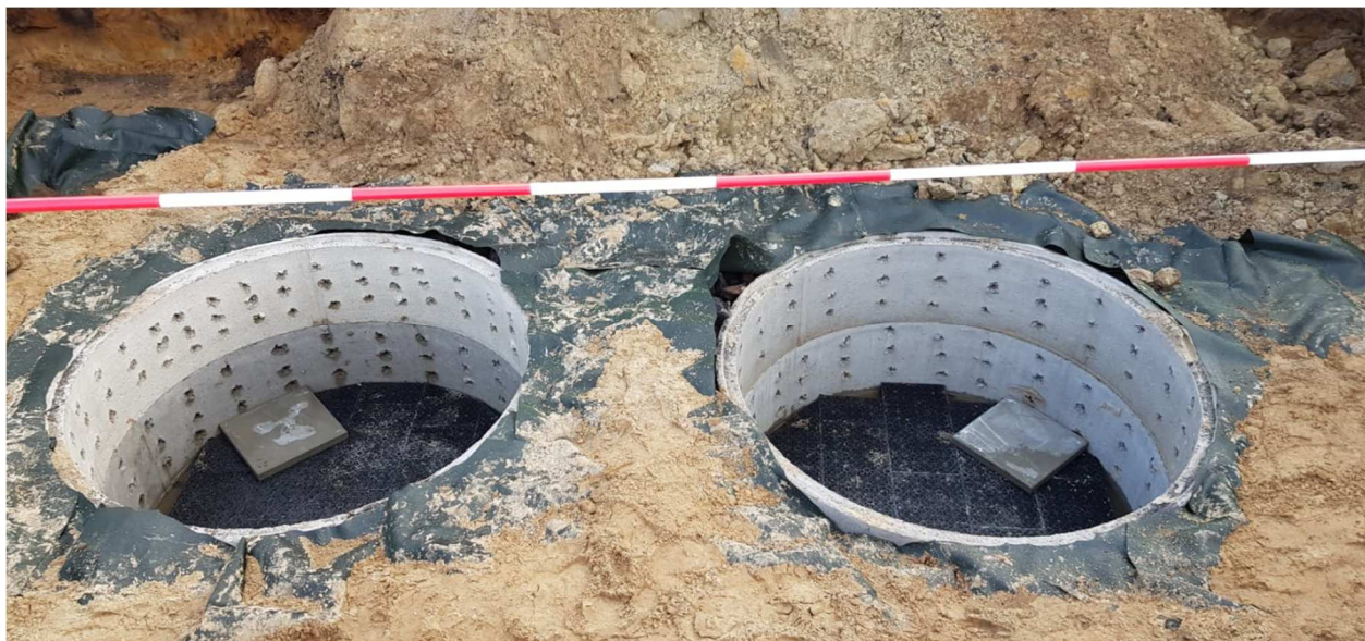
Figuur 13 Infiltratieput toegepast in Lochem voor de infiltratie van hemelwater
